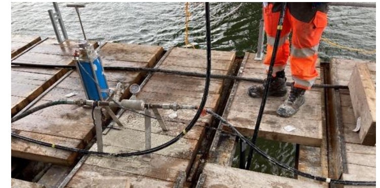
Injection de traitement en cours Descente de l'obturateur à la cote du traitement, puis gonflage de l'obturateur double grâce à une pompe Pavayet
