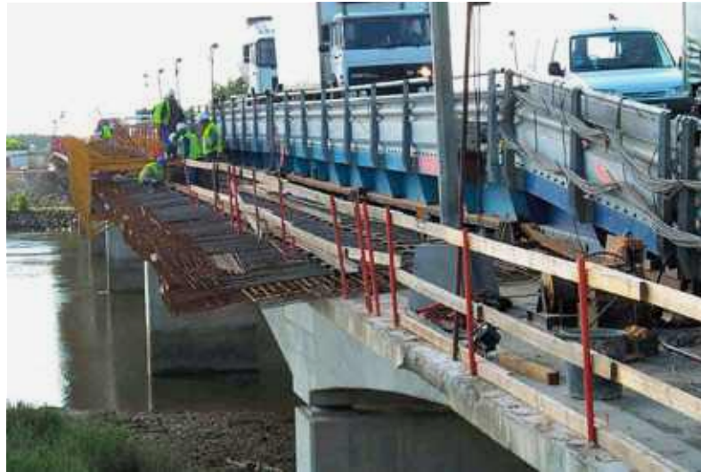
Photo n° 118 : tablier provisoire pour le maintien de la circulation et ferrailage de l'élargissement du pont de Bellevue (crédit photo CÉTÉ de l'Ouest - M.D. Guillot)
