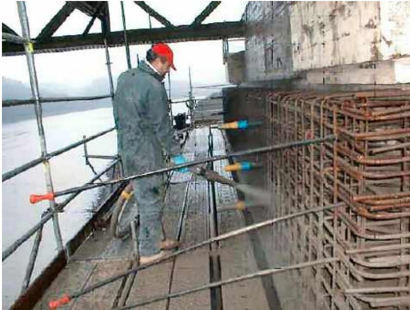
Photo n° 88 : ceinturage de la base des pylônes en cours de bétonnage par projection (crédit photo Freyssinet)
