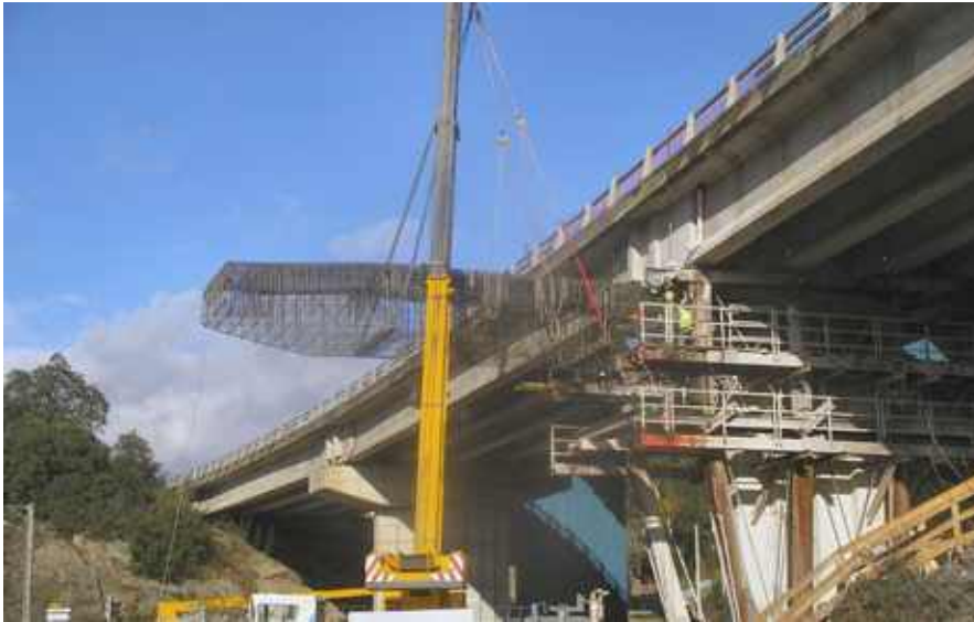
Photo n° 91 : mise en place du ferrailage du nouveau chevetre (crédit photo CÉTÉ d'Aix-en-Provence - M. Broquet)
