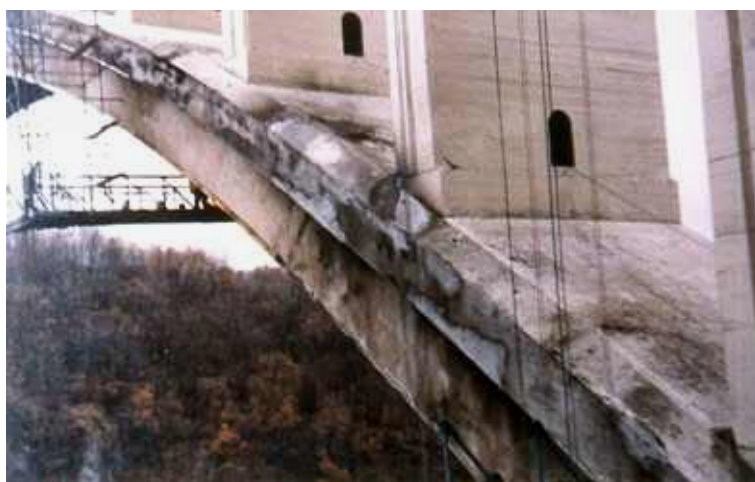
Photo n° 63 : vue de l'arc après projection et avant mise en place d'une chape d'étanchéité (crédit photo D. Poineau)
