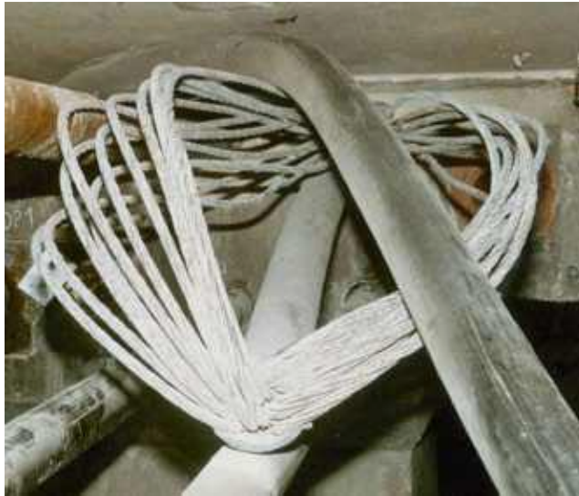
Photo n° 109 : effets de la détension brutale de câbles extérieurs longs protégés par un coulis de ciment (crédit photo D. Poineau)
