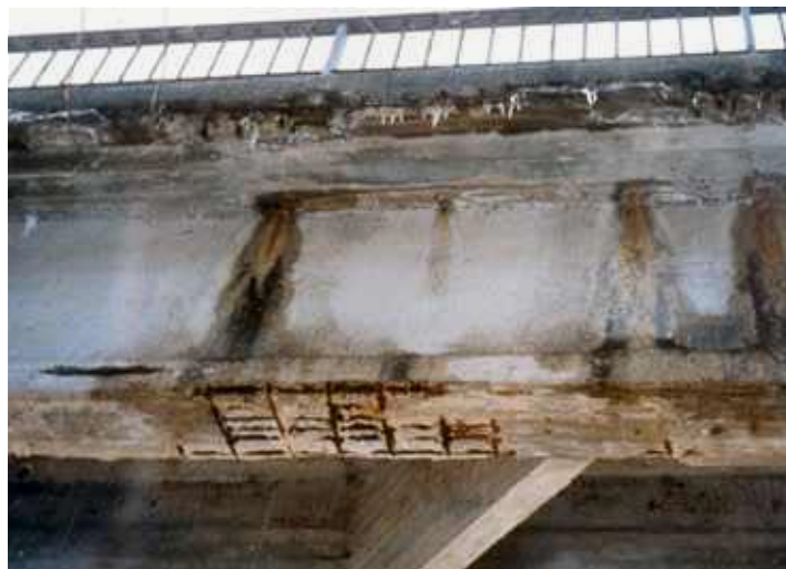
Photo n° 50 : conséquences de l'absence d'une étanchéité sous trottoir et d'une non-réfection de celle-ci en temps utile (crédit photo D. Poineau)
