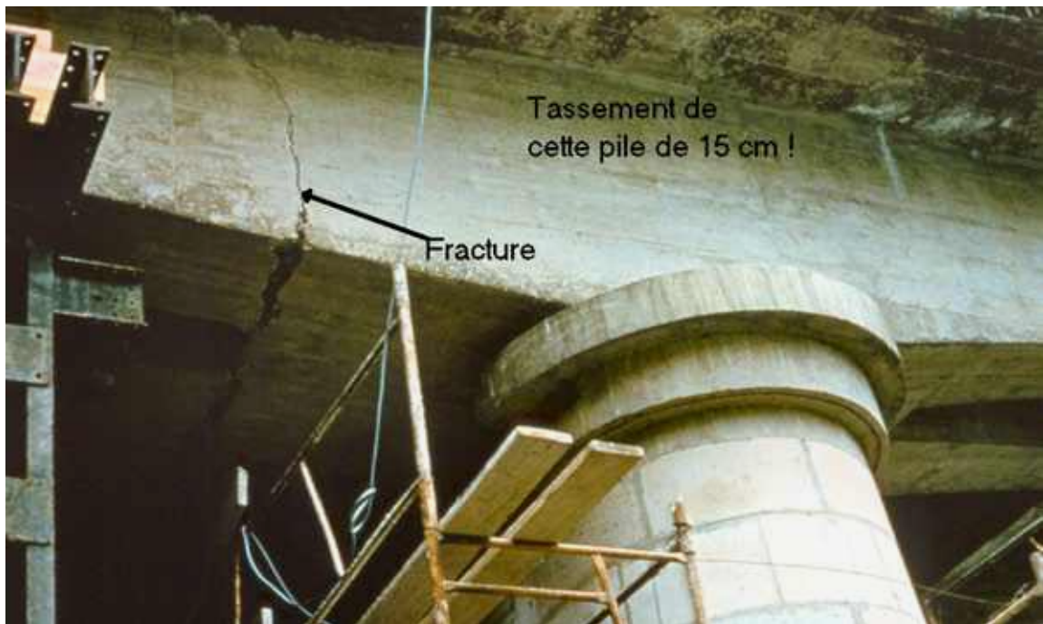
Photo n° 113 : rupture d'une des poutres en béton armé du pont d'Euilly (crédit photo D. Poineau)
