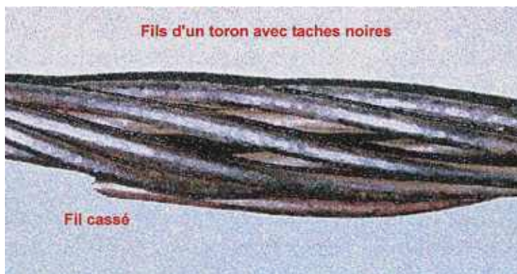
Photo n° 47 : piqûres avec taches noires symptômes d'une corrosion fissurante sous tension (extrait du guide technique VIPP du LCPC d'octobre 2001)
