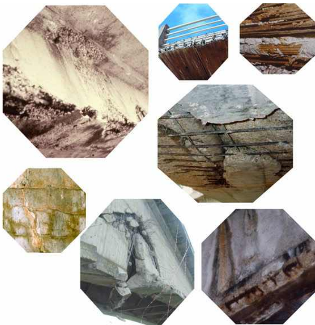
Photo n° 5 : différents désordres de structures en béton armé et précontraint (photomontage)
