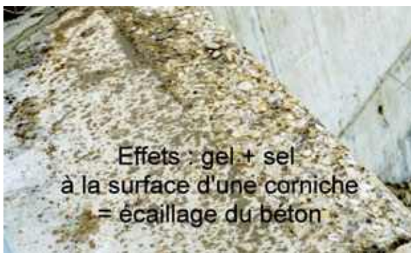
Photo n° 7 : béton affecté par l'écaillage (crédit photo D. Poineau)
