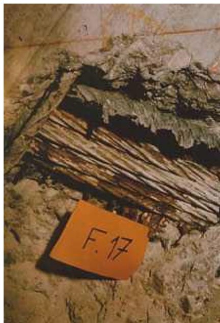
Photo n° 46 : fenêtre montrant l'absence de coulis et la corrosion des torons (crédit photo LR)
