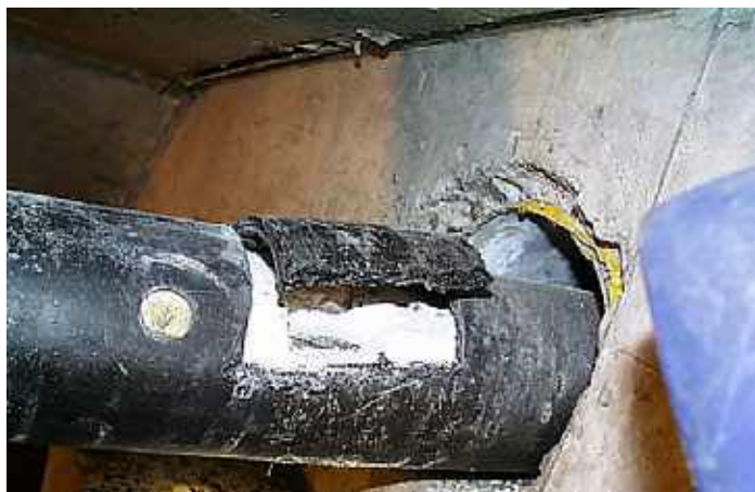
Photo n° 38 : présence de la pâte blanche dans un conduit de précontrainte extérieure injectée au coulis de ciment (crédit photo Services techniques de la Réunion)
