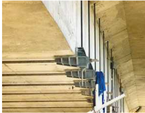
Photo n° 123 : renforcement à l'effort tranchant par étriers actifs en acier inoxydable du pont de Labéraudie (crédit-photo D. Poineau)
