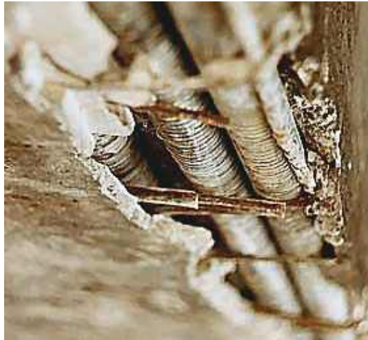
Photo n° 43 : défaut de bétonnage sous le talon d'une poutre préfabriquée constaté après un sondage au marteau (crédit photo LRPC de Strasbourg)
