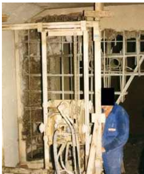
Photo n° 6 : démolition limitée au béton de mauvaise qualité d'un déviateur du pont de Bergerac (crédit photo J.M. Lacombe)
