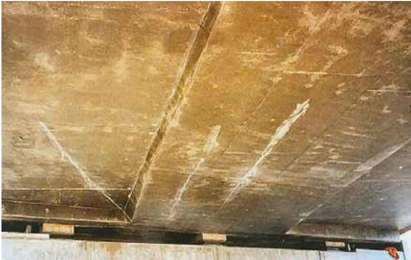
Photo n° 48 : non prise en compte des effets de diffusion des efforts concentrés sous les ancrages et de l'effet d'échelle dans ce pont-dalle à nervure étroite et très larges encorbellement et, de plus biais (crédit photo D. Poineau)
