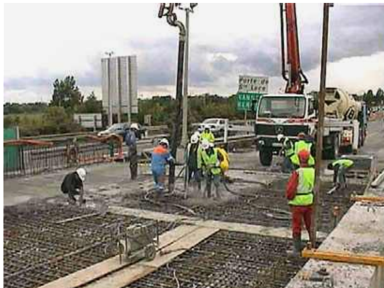
Photo n° 119 : bétonnage du dernier plot de l'élargissement du pont de Bellevue (crédit photo CÉTÉ de l'Ouest - M. D. Guillot)
