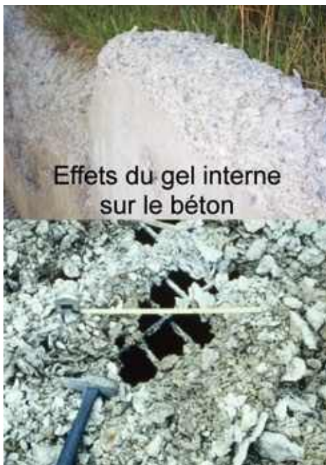
Photo n° 8 : bétons affectés par le gel interne (crédit photo D. Poineau)
