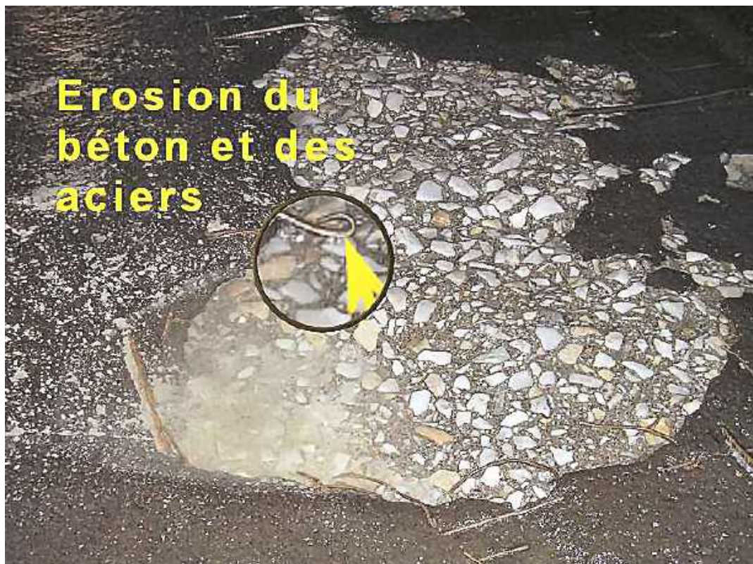
Photo n° 17 : érosion hydraulique du radier de la chute des Bois près de Chamonix (crédit photo Weargrit)
