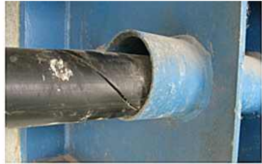
Endommagement de gaine au droit d'un déviateur
