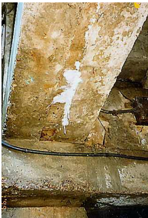
Photo n° 41 : trace de calcite sous le talon d'une poutre d'un VIPP (crédit photo D. Poineau)
