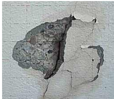
Photo n° 24 : exemple de corrosion avec polarisation cathodique (crédit photo Freyssinet)
