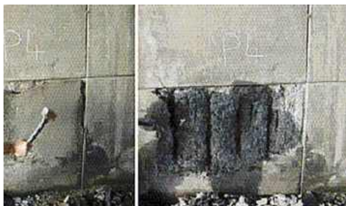
Photo n° 20 : dégradations du béton d'une pile dues à l'eau d'une lagune (crédit photo Freyssinet)
