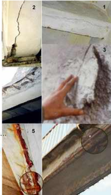
Photo n° 25 : manifestations visuelles de la corrosion (crédit photo D. Poineau)
