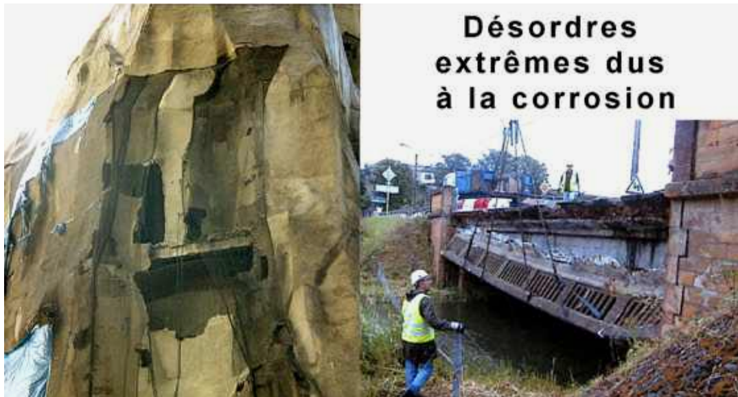
Photo n° 27 : exemple de désordres extrêmes dus à la corrosion – Grand Rocher du Zoo de Vincennes avant réhabilitation – Encorbellement d'un pont (crédit photo D. Poineau)
