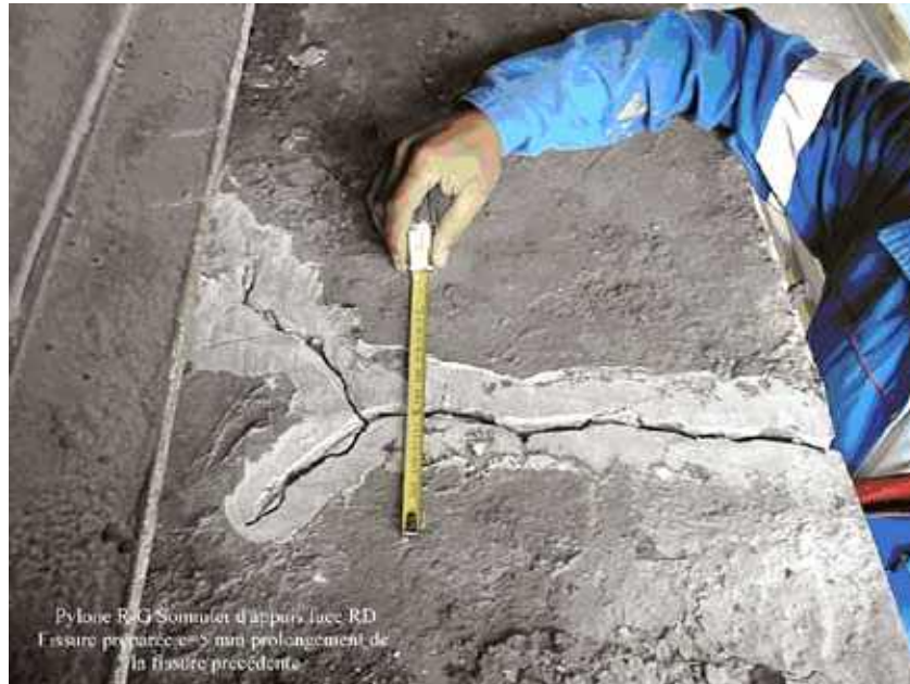
Photo n° 86 : importance de la fissuration (crédit photo Freyssinet)
