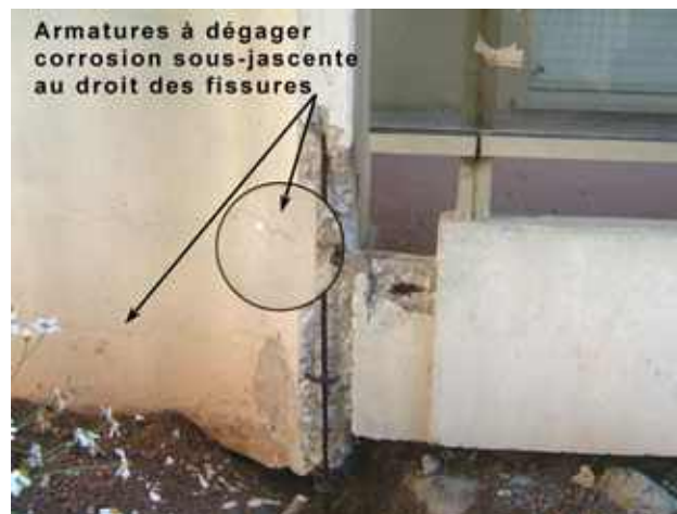
Photo n° 159 : toutes les armatures corrodées doivent être dégagées (crédit photo Parexlanko)
