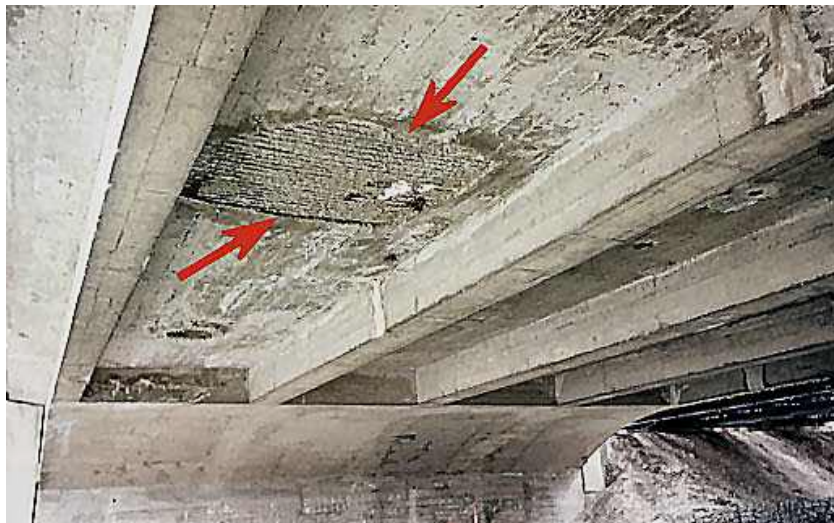
Photo n° 57 : état de désorganisation du béton du hourdis (crédit photo D. Poineau)
