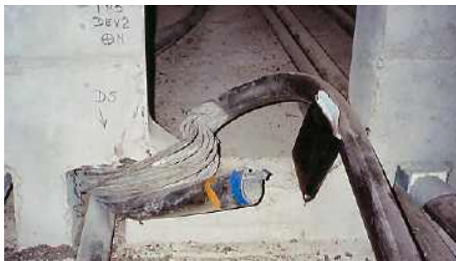
Photo n° 44 : le fouettement du câble, ici un 12T15, est la conséquence de la rupture par corrosion de cette armature de précontrainte extérieure (crédit photo D. Poineau)
