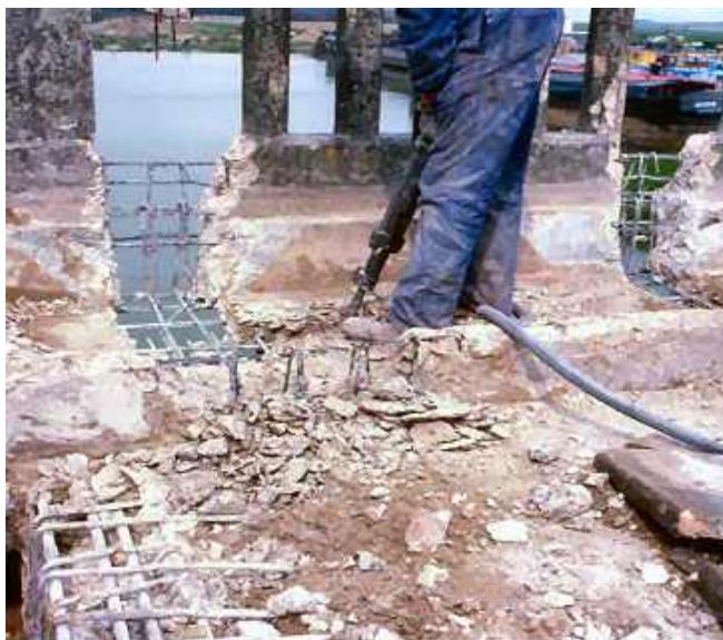
Photo n° 157 : incidences néfastes du marteau-piqueur sur le ferrailage (crédit photo Poineau)
