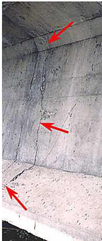
Photo n° 40 : fissuration d'une poutre isostatique en béton précontraint (crédit photo LRPC d'Aix-en-Provence)
