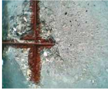
Photo n° 161 : mauvaise application d'un revêtement anticorrosion : les aciers n'ont pas été détourés et le produit a été aussi appliqué sur le béton (crédit photo D. Poineau)
