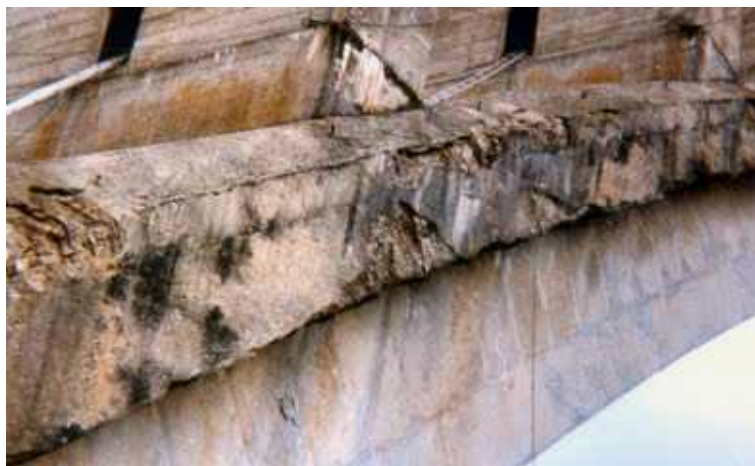
Photo n° 61 : état du béton d'un des bandeaux de l'arc (crédit photo DDE 74)
