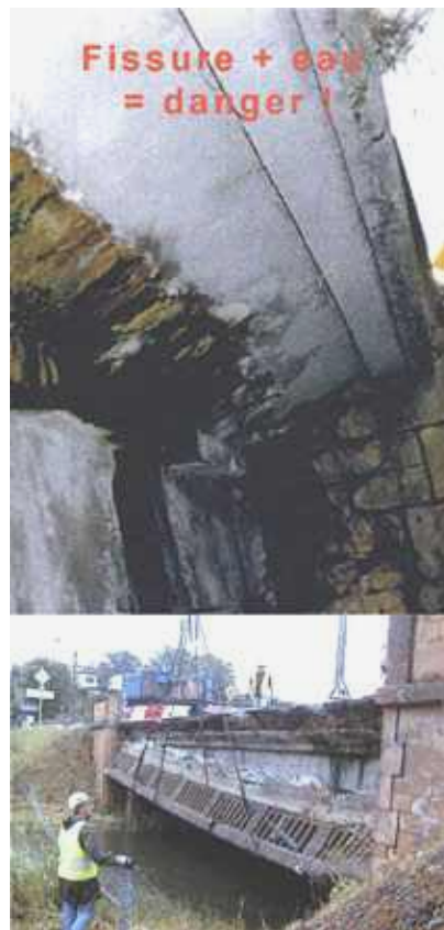
Photo n° 29 : fissure avec passage d'eau et conséquences de la corrosion localisée ainsi induite (crédit photo DDE54)
