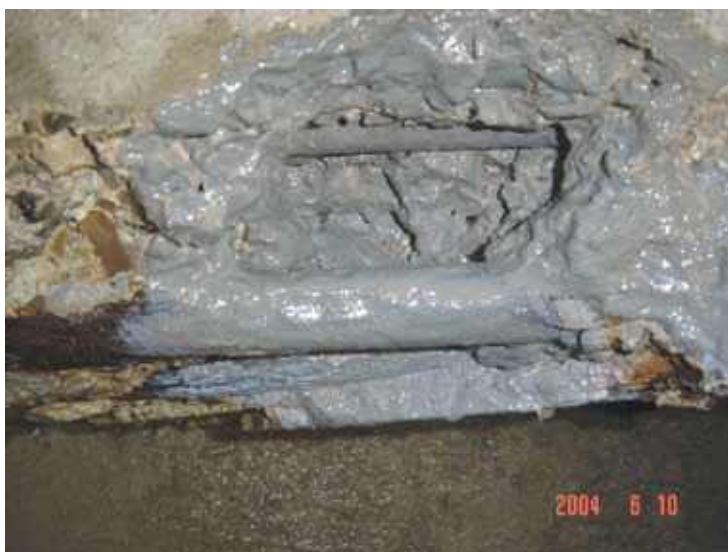
Photo n° 162 : exemple de réparation présentant le risque d'une inversion de polarité
