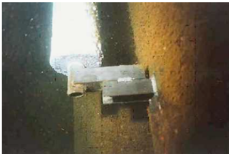
Photo n° 106 : anode extérieure sur un pieu métallique (crédit photo Grimaldi)
