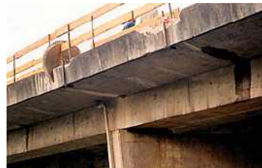
Photo n° 53 : procédure de sciage d'une partie d'un encorbellement d'un pont en béton précontraint non portée à la connaissance du chargé de l'opération (Crédit photo D. Poineau)
