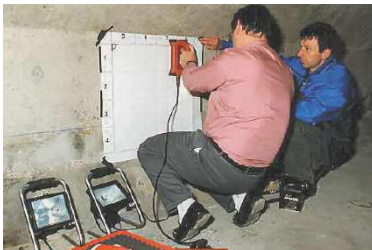
Photo n° 34 : relevé de la position des armatures de béton armé avec un pachomètre (crédit photo D. Poineau)
