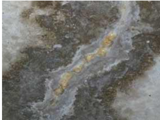
Photo n° 28 : passage d'eau au travers de la fissure d'une dalle (crédit photo D. Poineau)
