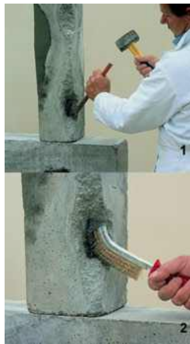
Photo n° 95 phases 1 et 2 d'une réparation par enlèvement du béton pollué (crédit photo Parexlanko)
