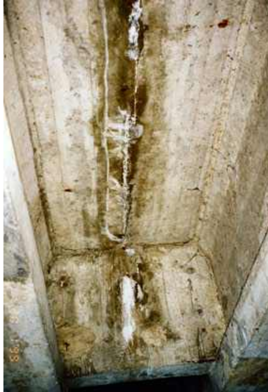
Photo n° 18 : traces de calcite dues au passage de l'eau à travers le béton faute d'une chape d'étanchéité efficace (crédit photo D. Poineau)
