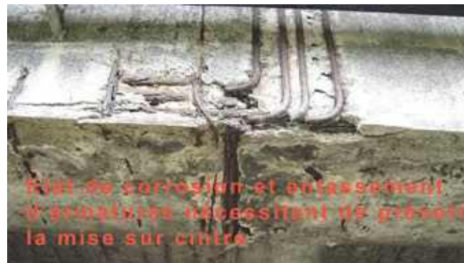
Photo n° 160 : entassement de barres dans une structure ancienne (crédit photo Parexlanko)
