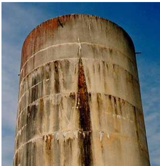
Photo n° 3 : désordres d'un réservoir d'eau potable (crédit photo D. Poineau)
