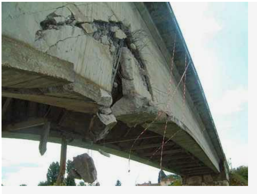
Photo n° 51 : conséquences sur le tablier d'un pont du choc de bateau n'ayant pas respecté le gabarit de navigation (crédit photo du CÉTÉ de Lyon)
