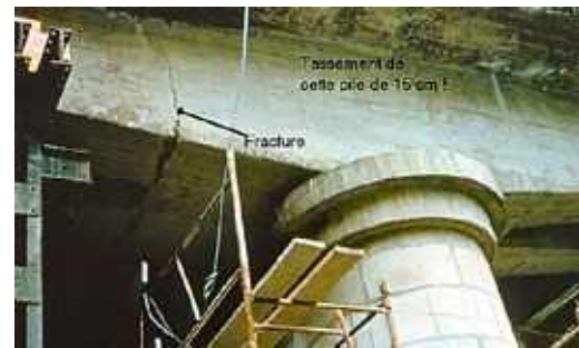
Photo n° 52 : conséquences structurales sur le tablier (crédit photo D. Poineau)
