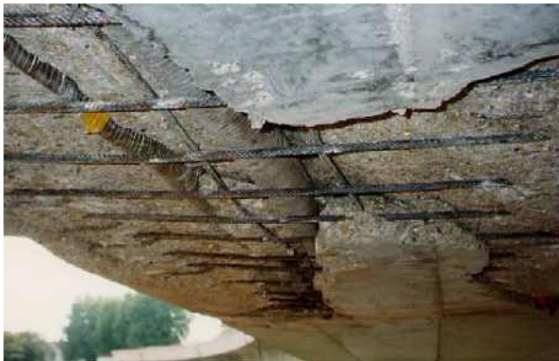
Photo n° 114 : désordres du hourdis inférieur dus à une poussée au vide locale (crédit photo D. Poineau)
