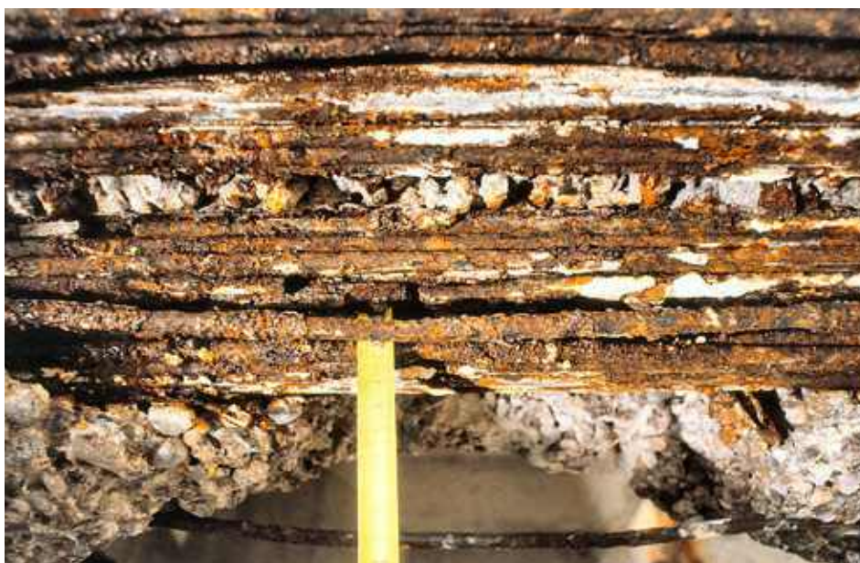
Photo n° 36 : pont de Crévechamps, corrosion par dissolution d'armatures de précontrainte internes au béton (crédit photo LRPC de Strasbourg)
