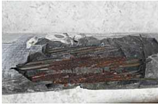
Corrosion avancée du câble avec rupture de fils
