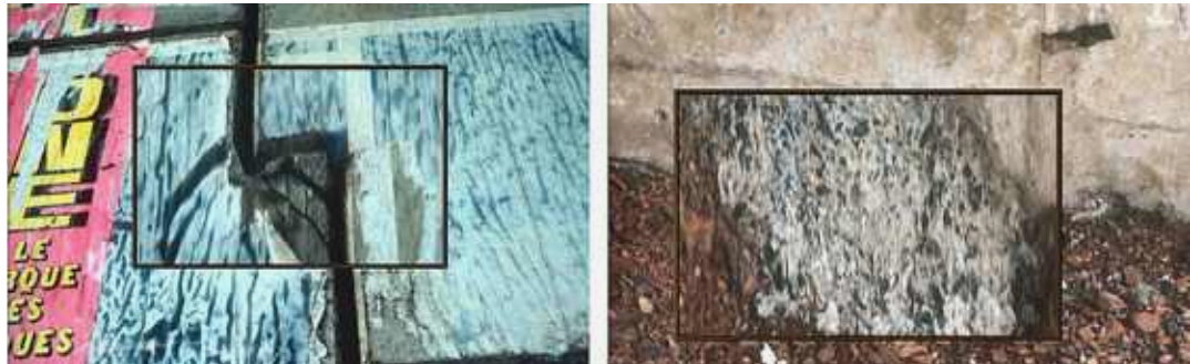
Photo n° 19 : dégradations du béton par une attaque sulfatique externe (crédit photo LCPC)
