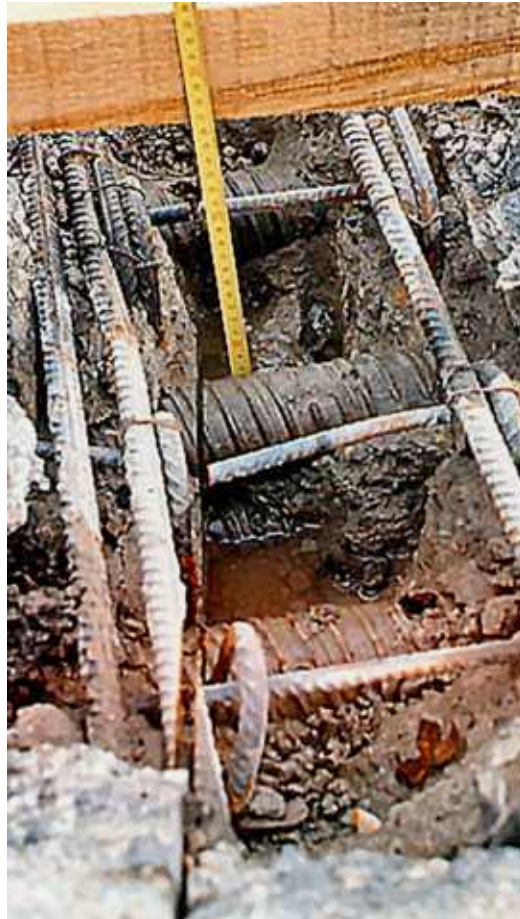
Photo n° 54 : conséquences 6 câbles de précontrainte sectionnés dans la poutre de rive (crédit photo D. Poineau)
