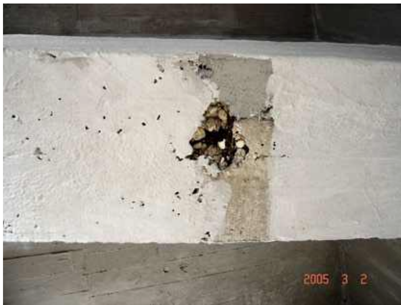
Photo n° 176 : défauts d'exécution (crédit photo Parexlanko)
