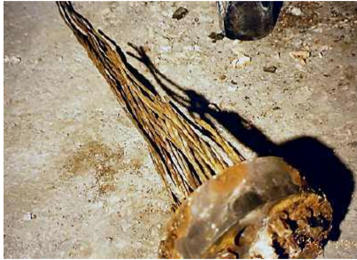
Photo n° 49 : rupture par corrosion d'une armature de précontrainte extérieure au béton engendrée par la présence « d'eau fossile » liée à une injection mal exécutée (crédit photo D. Poineau)
