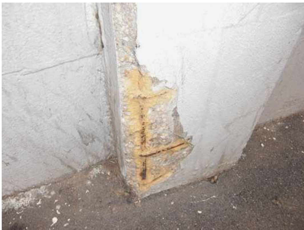
Photo n° 31 : constat d'une nouvelle corrosion quelques années après une réparation mal exécutée (crédit photo D. Poineau)
