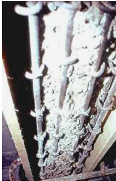
Photo n° 98 : résultats d'un décapage des armatures au moyen d'abrasifs au pont de Limay (crédit photo D. Poineau)
