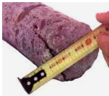
Photo n° 12 : fissure non traversante
