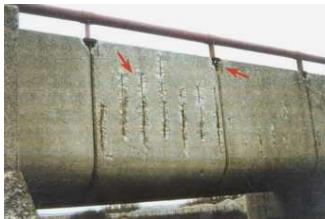
Photo n° 33 : défaut d'enrobage, cause de la corrosion des armatures (crédit photo LRPC de Strasbourg)
