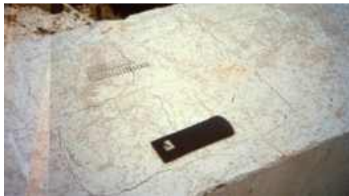
Photo n° 11 : fissures de ressuage
