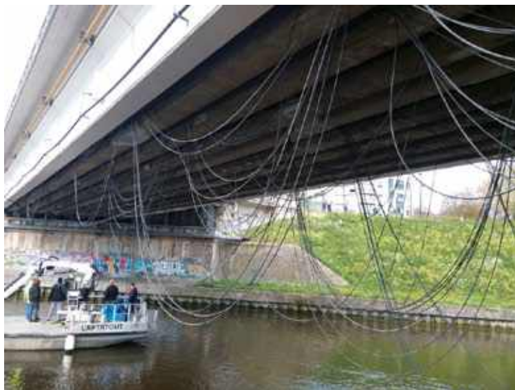
Photo n° 10 : état de la précontrainte additionnelle d'un VIPP après un incendie (crédit photo CEREMA)
