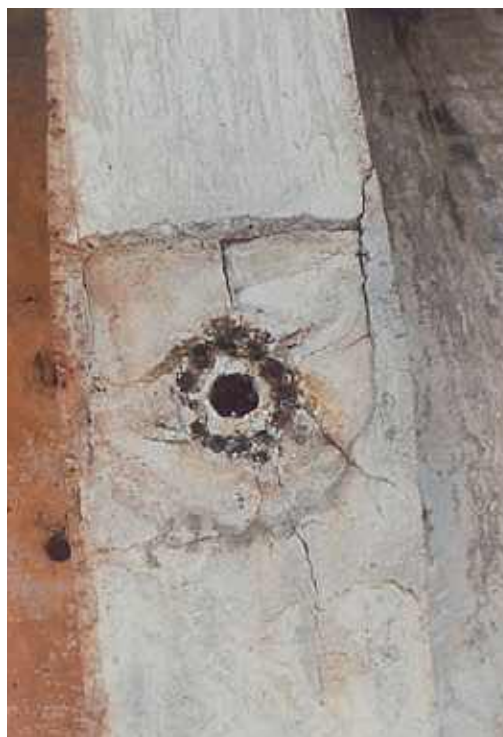
Photo n° 42 : ancrage sans protection (crédit photo D. Poineau)
