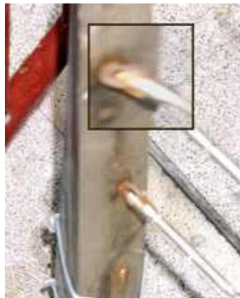
Photo n° 2 : corrosion d'un acier inoxydable au droit de soudures (crédit photo D. Poineau)
