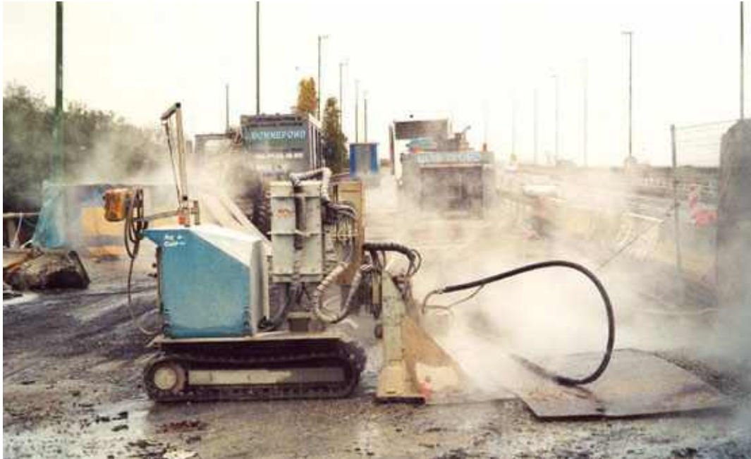
Photo n° 9 : dispositifs de protection au viaduc d'Orgemont (crédit photo D. Poineau)
