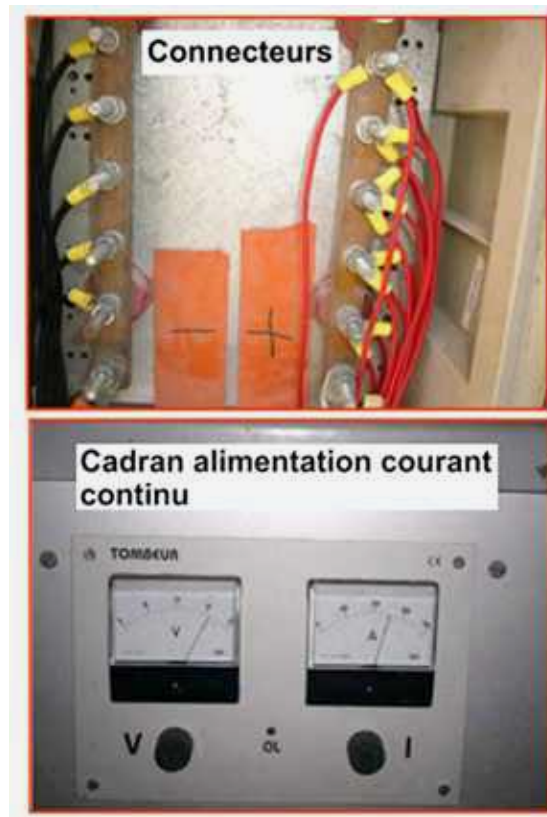
Photo n° 103 : extraction électrochimique des chlorures par courant imposé – Connecteurs et dispositifs de contrôle (crédit photo Ifsttar)
