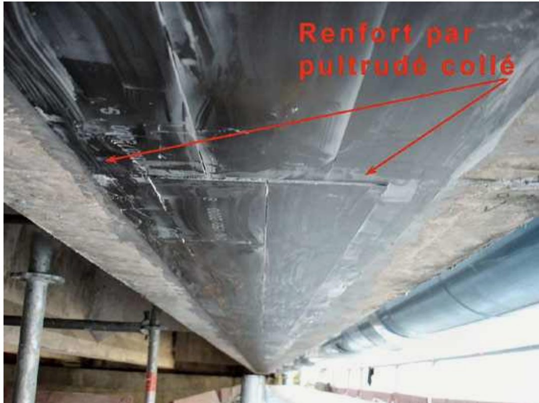
Photo n° 120 : renforcement de poutres fléchies par plaques de composites (pultrudés) (crédit photo VSL)
