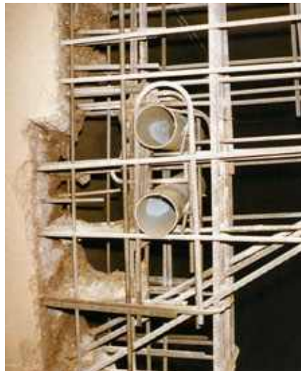
Photo n° 155 : résultats d'une hydrodémolition : enlèvement complet du béton et ferrailage intact (crédit photo J.M. Lacombe)
