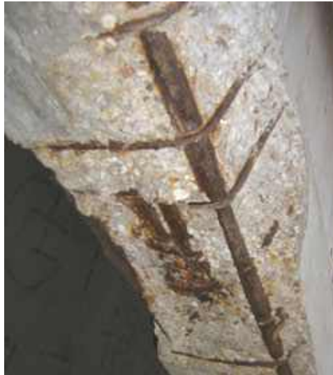
Photo n° 169 : dégageant insuffisant des armatures – absence de détourage (crédit photo Parexlanko)
