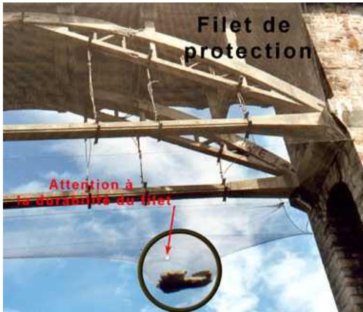
Photo n° 26 : filet de protection contre les chutes de morceaux de béton (crédit photo D. Poineau)
