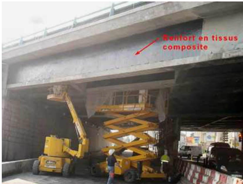
Photo n° 121 : renforcement de poutres en béton armé à l'effort tranchant PI A 6 à Arcueil (crédit photo VSL – M. Loubeyre)
