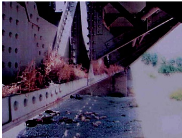
Figure 30 : Renforts de membrure inférieure formant piège à eau et / ou piège à poussière (photo Jean-Paul PERSY).
