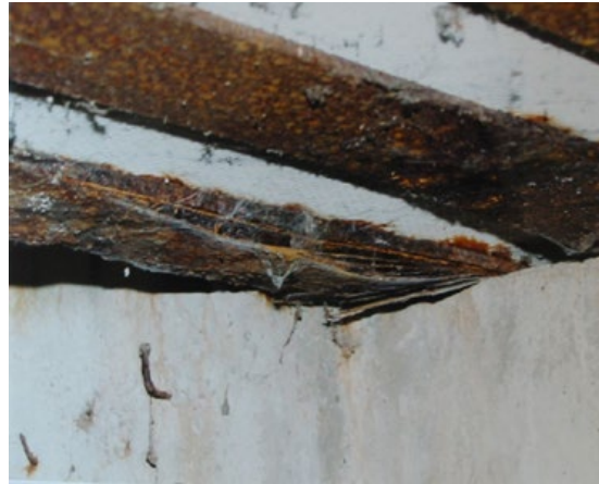
Figure 32 : Corrosion feuilletante d'une membrure inférieure d'une poutre d'un pont à poutrelles enrobées (photo Jean-Paul PERSY).
