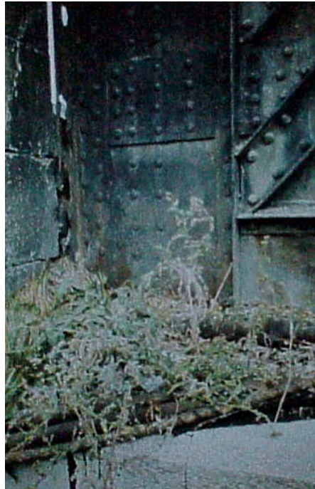
Figure 29 : Piège à poussière, maintien de l'humidité, végétation, foyer de corrosion (photo Jean-Paul PERSY).
