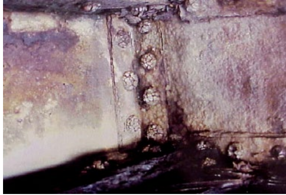
Figure 39 : Corrosion des têtes de rivet, risque de perte de résistance à la traction sous tête (photo Jean-Paul PERSY).
