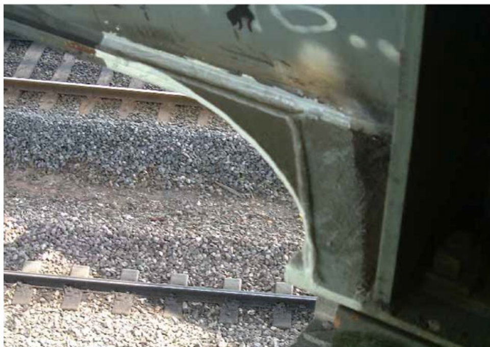
Fig. 95 a et b : Désordre de fatigue et réparation avec gousset d'épanouissement (photos Jean-Paul PERSY).
