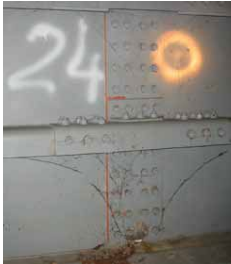
Fig. 71 : Glissement des pièces au niveau d'un joint de rabotage sous effort excessif (effondrement partiel de l'ouvrage). Mise en évidence par rupture du feuil de peinture et mise à nu de la sous couche au minium de plomb (photo Jean-Paul PERSY).
