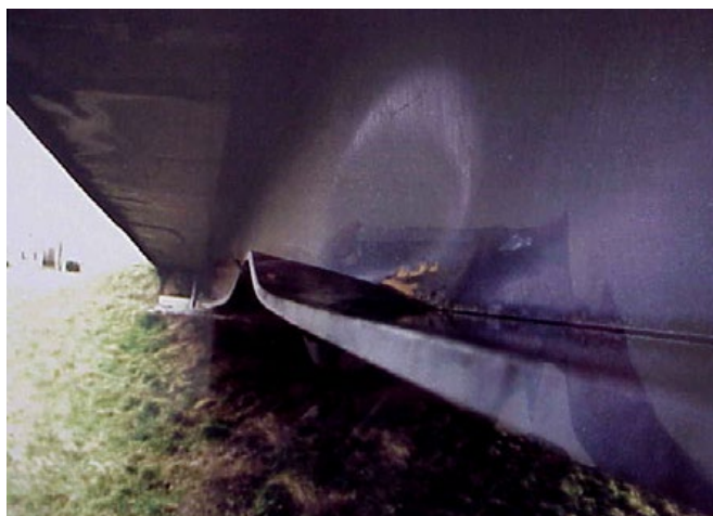
Figure 85 : Choc de véhicule sur ouvrage moderne - déformations de la membrure inférieure et de l'âme de poutre (photo Jean-Paul PERSY).
