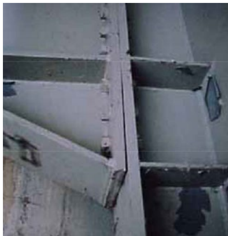
Fig. 128 : Assemblage par boulons HR sollicités parallèlement à l'axe des boulons - défaut d'alignement dû au retrait de soudage (photo Jean-Paul PERSY).
