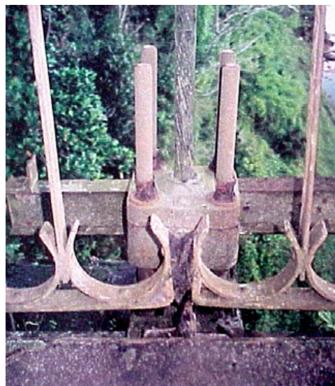
Figure 36 : Corrosion d'écrous (photo Jean-Paul PERSY).
