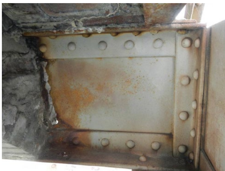
Figure 43 : Corrosion de pièce noyée dans la maçonnerie. Perforation de l'âme, corrosion des cornières de membrures au contact de la maçonnerie (photo Jean-Paul PERSY).
