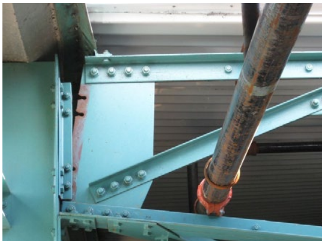
Figure 74 : Rupture par dépassement des efforts en pression diamétrale sur une charpente (photo Jean-Paul PERSY).
