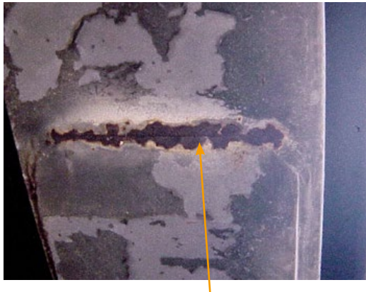
Figure 59 : Fissure frontale d'une semelle additionnelle de membrure inférieure de poutre (photo Jean-Paul PERSY).
