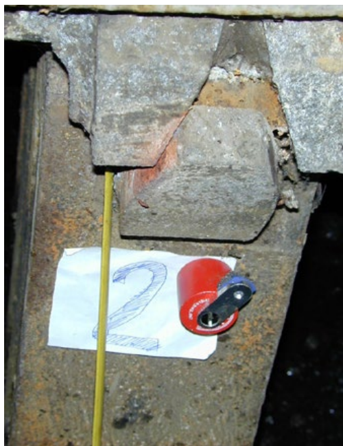
Figure 102 : Rupture du dispositif anti-cheminement sur appareil d'appui à balancier (photo Yves Picard).
