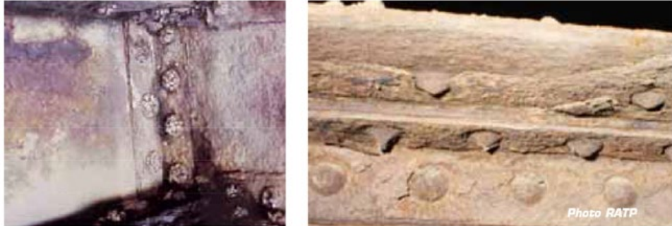
Fig. 64 : Corrosion de rivets (photo Jean-Paul PERSY).
