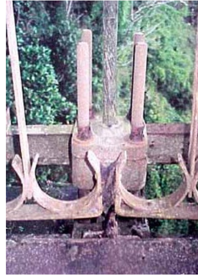
Fig. 69 : Corrosion spécifique des écrous d'une attache basse de suspension de pont suspendu (photo Menou - LCPC).
