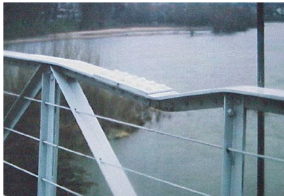
Figure 83 : Flambement de membrure supérieure de la poutre de rigidité dans le plan (photo Jean-Paul PERSY).
