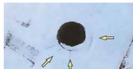
Fig. 63 : Fissuration sur trou de rivet (Photo SNCF).
