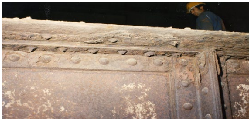
Figure 40 : Dégradation des têtes de rivet par corrosion (photo Jean-Paul PERSY).
