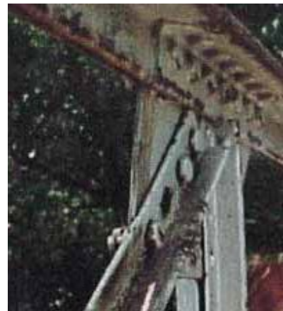
Fig. 70 : Déconsolidation d'un assemblage boulonné non précontraint d'une poutre treillis avec disparition d'un boulon de l'assemblage (photo Jean-Paul PERSY).
