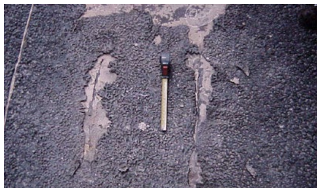
Figure 57 : Fissuration par fatigue de tôle de platelage sous l'effet de la circulation - ici platelage de 10 mm sur autoponts (photo Jean-Paul PERSY).
