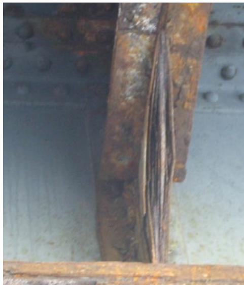
Figure 33 : Corrosion feuilletante d'un gousset sur un ouvrage des années 1960 (photo Jean-Paul PERSY).
