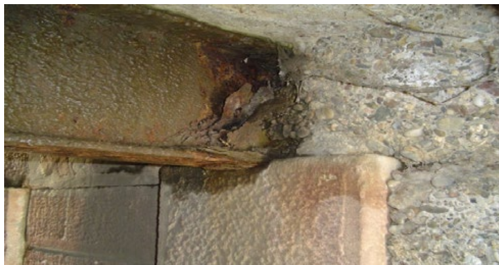
Figure 42 : Dégradation, avec écrasement de la zone d'appui d'une poutre encastrée, affaiblissement par corrosion (photo Jean-Paul PERSY).
